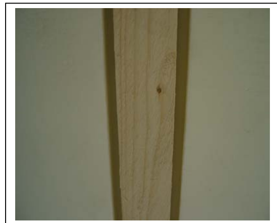
Kuva 4. Kuva pystyrunkopuun kohdalta, johon on kiinnitetty kuvassa näkyvä puurima. Puuriman avulla lämmöneriste painui tasaisesti koko matkalta pystyrunkopuuta vasten.
